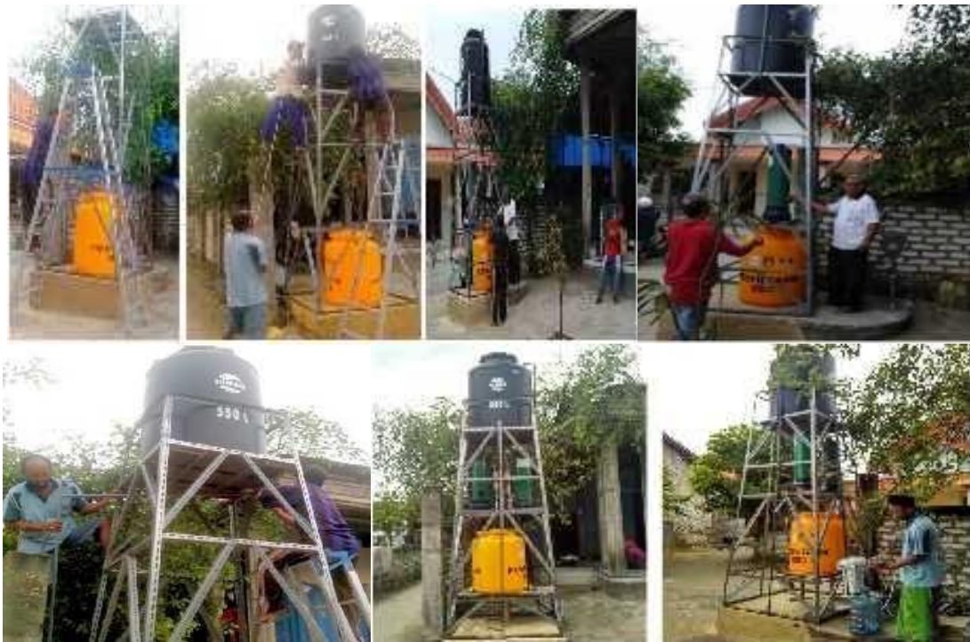
Gambar 4. Instalasi peralatan pengolahan air payau menjadi air bersih
